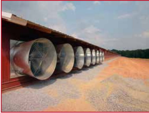
Figura 6.13: Ejemplo típico de un galpón con ventilación de túnel.
