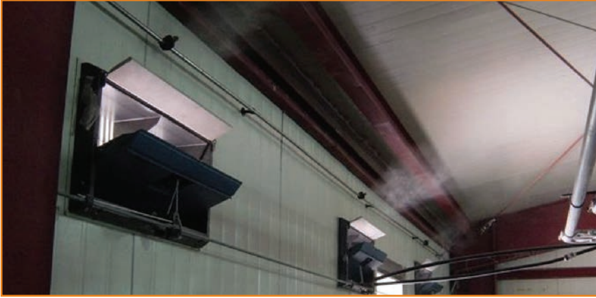
图 6.21：横向通风的鸡舍所使用的喷雾系统示例。
