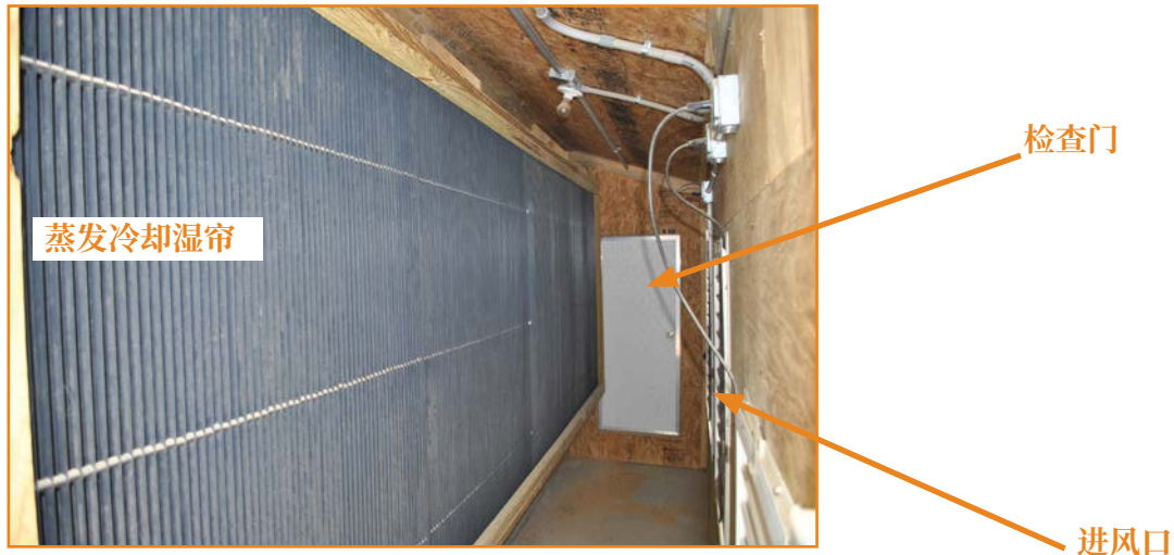
图 6.20：鸡舍侧墙上安装在侧室中的湿帘示例。
